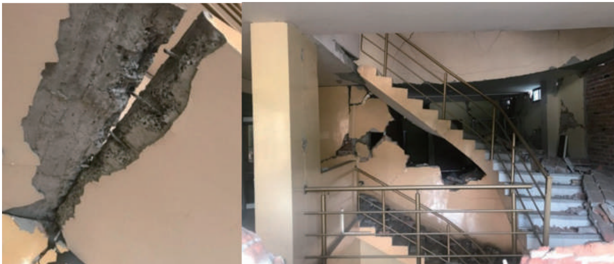
Figura 2. Conexión de la escalera a la losa de primer piso, a la izquierda. Paredes colapsadas alrededor de las escaleras, a la derecha.
