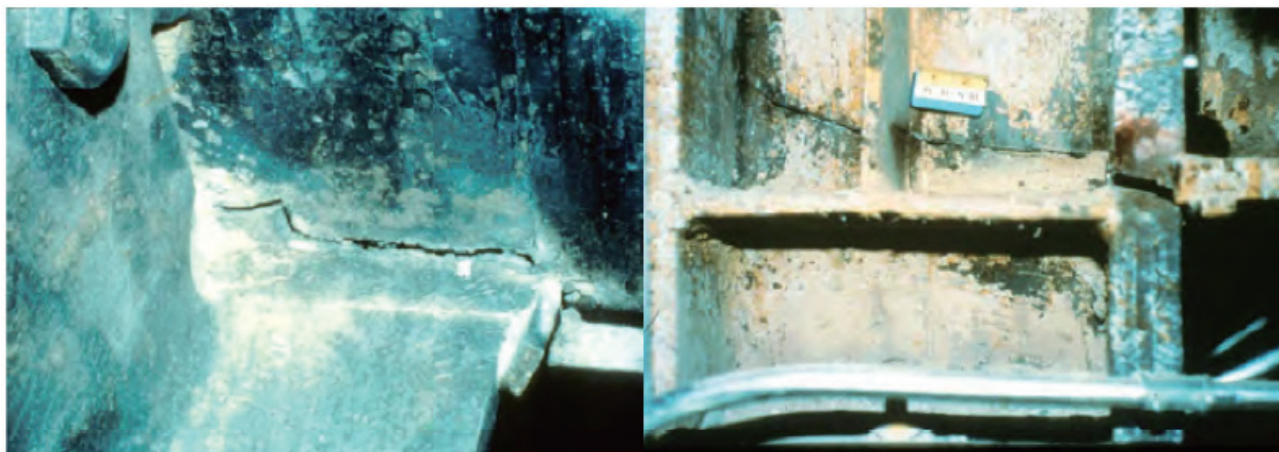
Figura 1. Fracturas típicas en el Sismo de Northridge
