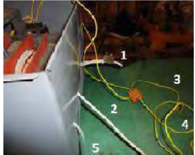
Figura 11. Conexiones del equipo a dispositivos: DAQ y Seccionador
