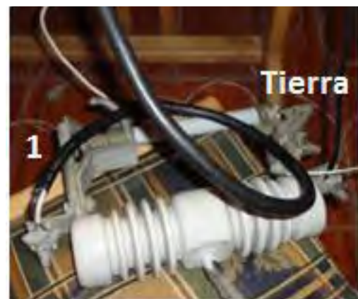
Figura 12. Conexión al Seccionador
