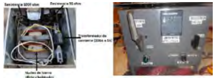
Figura 7. Elementos colocados y conectados del equipo de medida
