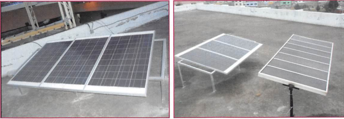
Fig 3.4 Módulos Fotovoltaicos Instalados
